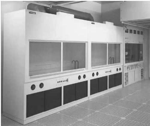
クリーンルーム内ドラフトチャンパー設置例
