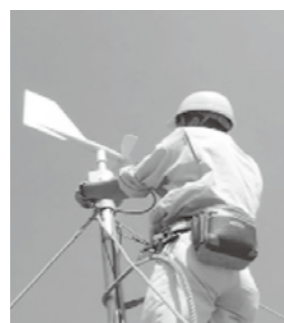
地震計、風向風速計、雨量計などの気象防災用の計測機器を保守点検しています。
